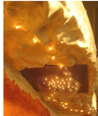
Licht-Deckengestaltung aus FORMETAL VARIUS mit Verbundsystem FLEXORIT kombiniert mit Halbkugel aus sichtbarem FORMETAL YPSILON (Ladenbau, Innenarchitektur)
